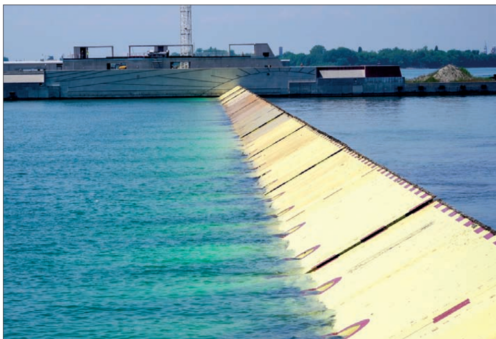
La prova di movimentazione delle paratie di una delle bocche del MOSE avvenuta durante il collaudo in fase di allestimento
