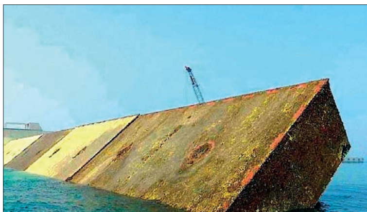
Ancora alcune paratie in fase di emersione durante una prova dello scorso anno: sono evidenti gli effetti della permanenza in mare del manufatto
